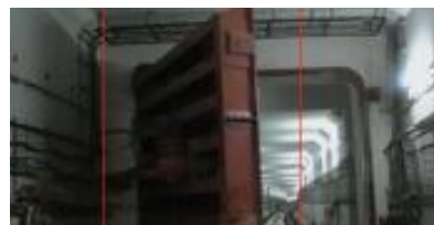
▲ 人防门入侵监控
