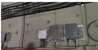
▲ 隧道壁挂箱异常监测
